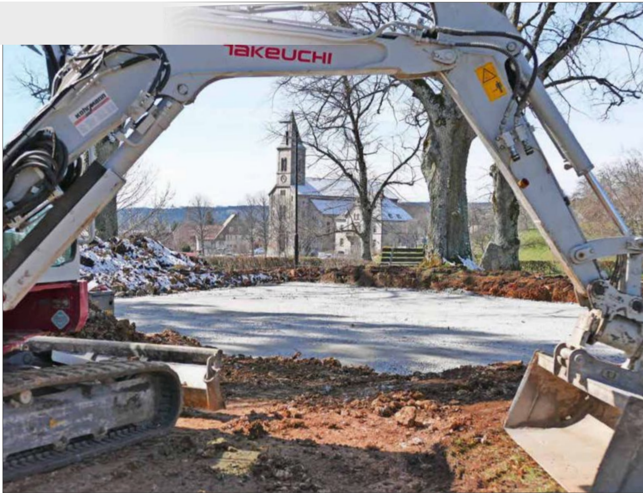
Die Arbeiten zur Calisthenics-Anlage am Philosophenweg haben begonnen. Die Anlage soll Ende April fertig sein.
